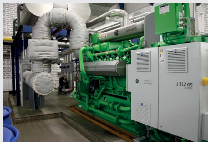
Blockheizkraftwerk 2 in Königsborn
