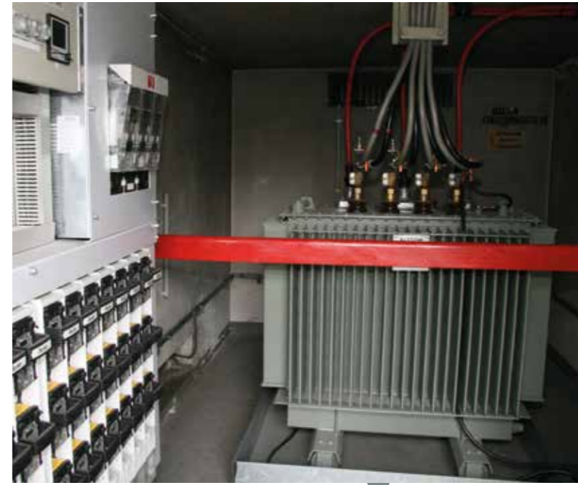
Beim Austausch von Transformatoren achten wir auf die höchste Effizienzklasse.
