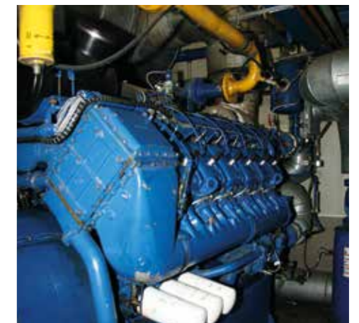
Blockheizkraftwerk 1 in der Gartenvorstadt
