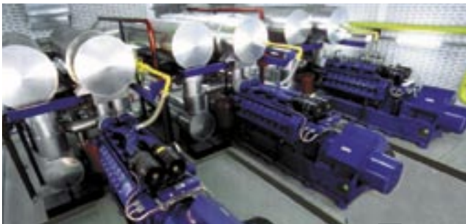
Blockheizkraftwerk 2 in Königsborn
