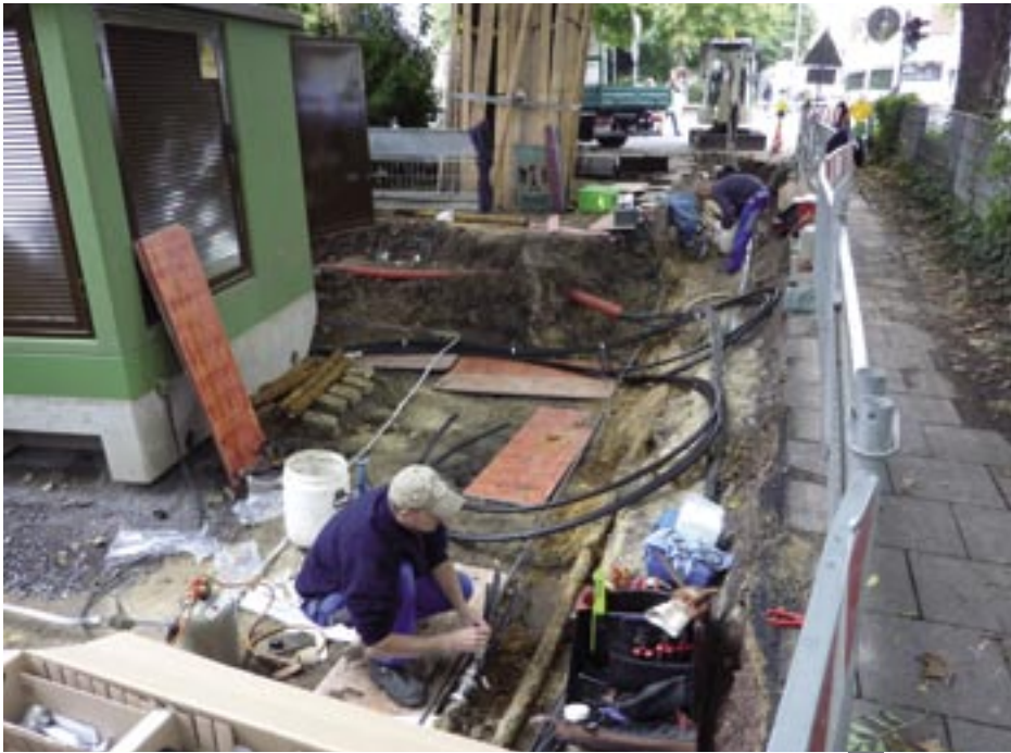
Neue Ortsnetzstationen liefern höhere Leistung für die Kunden.
