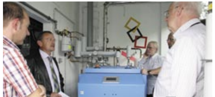
Blockheizkraftwerk im Massener Hellweg-Bad
