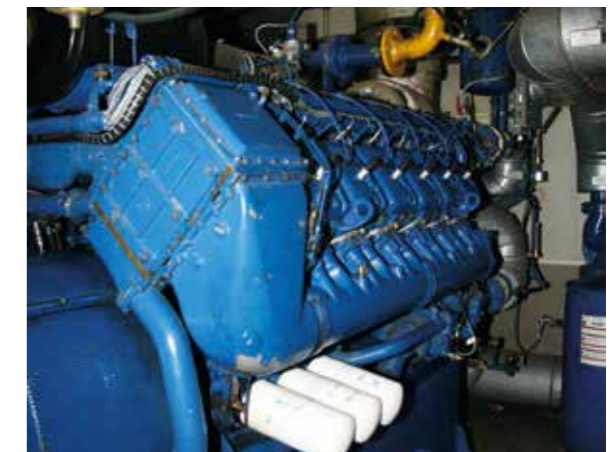
Blockheizkraftwerk 1 in der Gartenvorstadt
