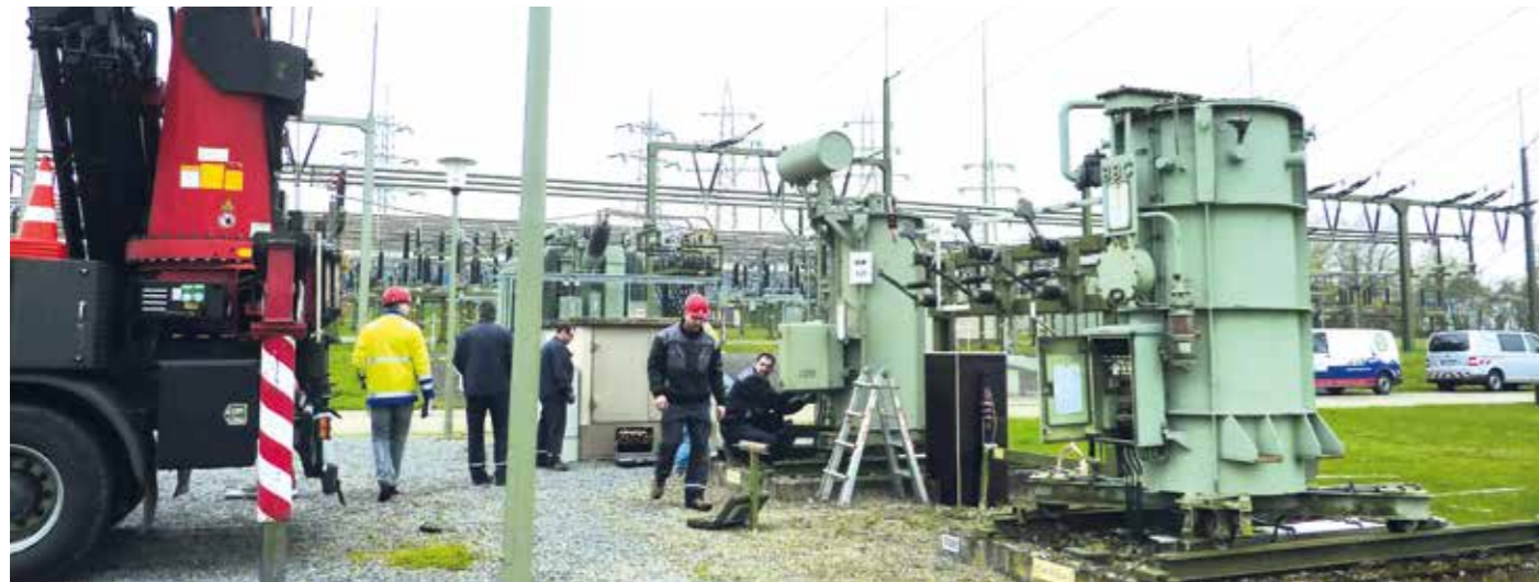
Millioneninvestition für die Versorgungssicherheit: Neue meterhohe „Erdschlusslöschspulen“ sorgen in Unnas Umspannwerken dafür, dass bei einem Defekt im Mittelspannungsnetz nicht sofort der Strom bei den angeschlossenen Verbrauchern ausfällt.
